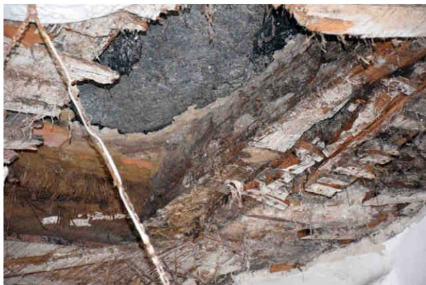
Einregnungsschäden in der Decke über dem Erdgeschoss, Aufnahme Verfasser, 04.03.2019
