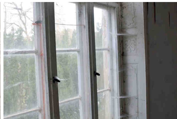
Fragmente eines historischen Kastenfensters mit innerer profilierter Laibungsverkleidung, Aufnahme Verfasser, 04.03.2019
