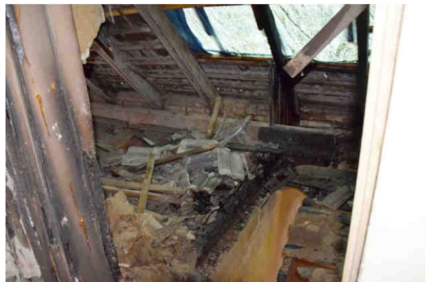
Einregnungs- und Brandschäden in der Dachhaut über dem Haupteingang und der Decke über dem EG, Aufnahme Verfasser, 04.03.2019
