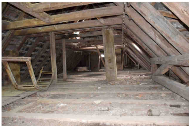
Ansicht des Dachstuhls im 2. Obergeschoss. Er ist unter wirtschaftlichen Aspekten als reparaturwürdig einzuschätzen. Aufnahme Verfasser, 04.03.2019
