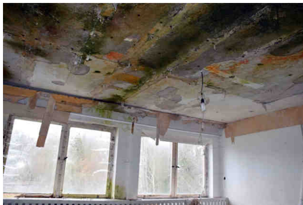
Ansicht der Decke im östlichen Anbau der 19070/80er Jahre; Hier ist von einem Totalverlust auszugehen. Aufnahme Verfasser, 04.03.2019
