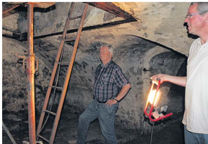
Jürgen Zarm vom Planungsbüro erklärt Martin Häring (rechts), welche Sicherungsarbeiten im Keller nötig sind. FOTOS (2): EE
